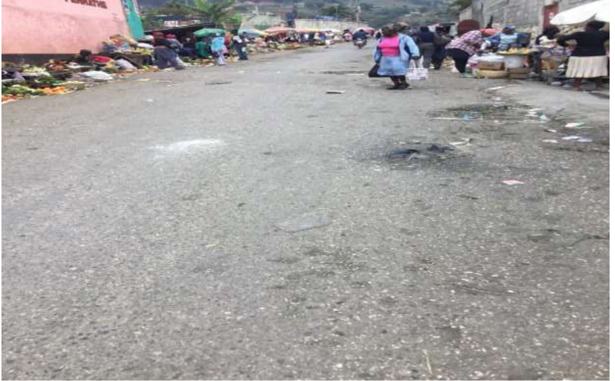
Chaussées dégradée ayant des cuvettes
