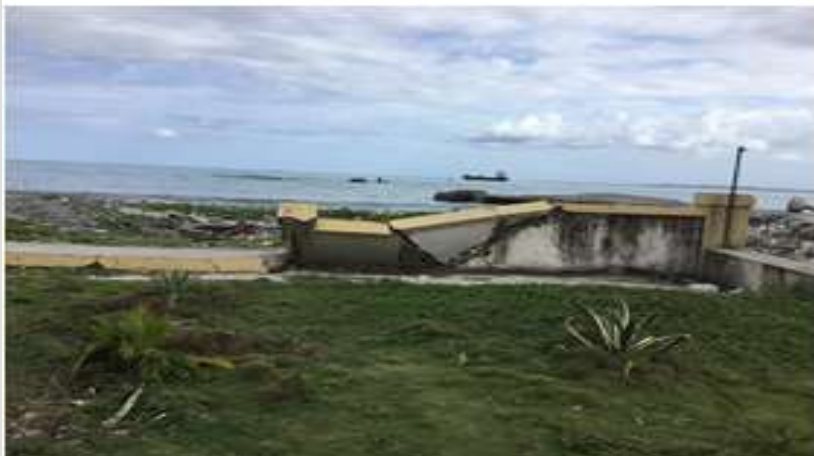
Photos 1, 2 et 3 : Le quai (la jetée), un bâtiment de services et le mur de protection en ruine
