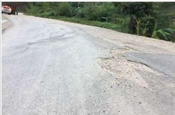
Photos 4, 5, et 6 : Voie en attente des couches d'asphaltage, stabilisation de la route et du canal d'évacuation des eaux et déficiences à reprendre
