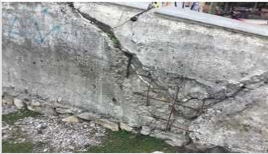
Photos 4, 5 et 6 : Mur de protection en ruine qui na pas résisté à la tornade
