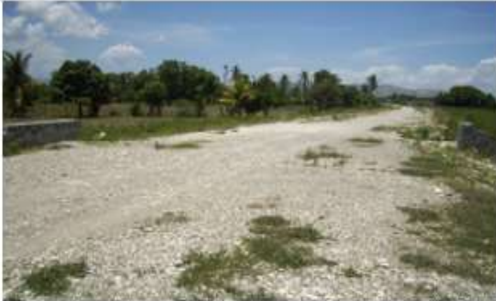
Chaussée en terre battue de la route de contournement de la ville des Gonaïves Bigot – Carrefour Joffre
