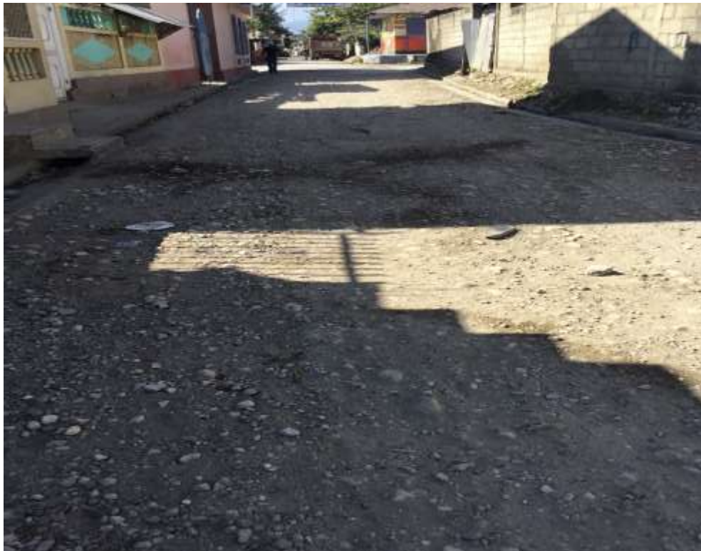
Caniveau les 2 bords de la rue, rue Paul E Magloire, près de 100m non adoquiné
