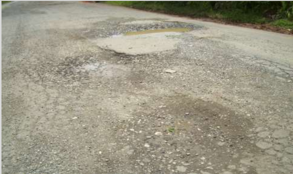
Photo présentant la chaussée fortement dégradée de la Route Carrefour Puilboreau - Marmelade
